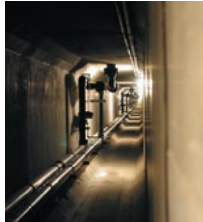
Red de control de infiltraciones
